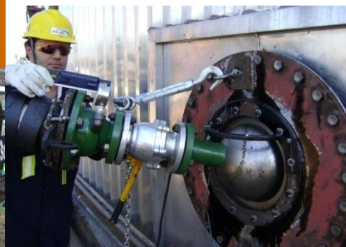
BR Mixer - Tanques
