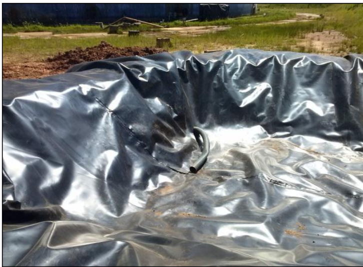
Piscina de captação do percolado.
